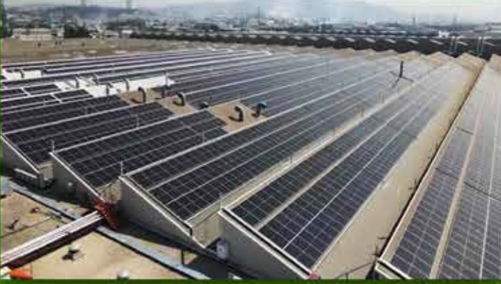
TOFAŞ Türk Otomobil Fabrikası A.Ş. GES 5000kWe / 6000kWp
